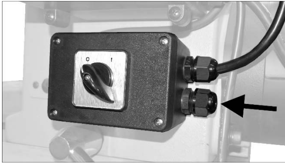
Figura 7-1: caja de interruptores principal
